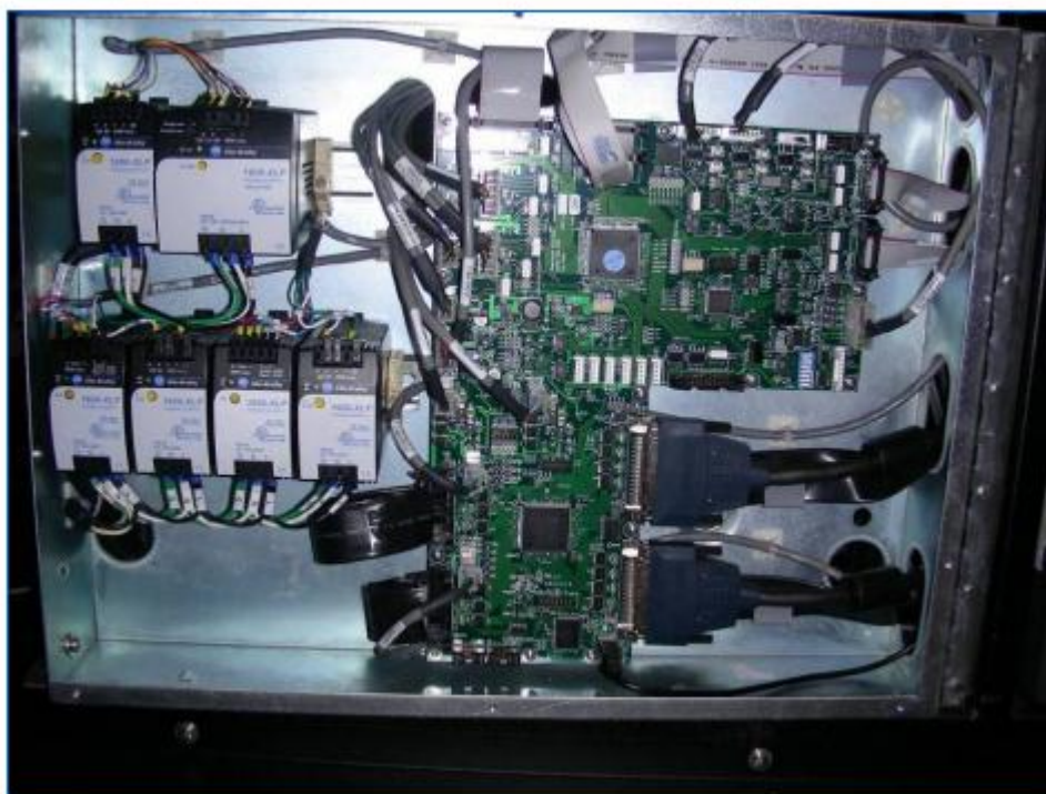
Рисунок 9-17: Блок электронного оборудования 628DV Щит 1
